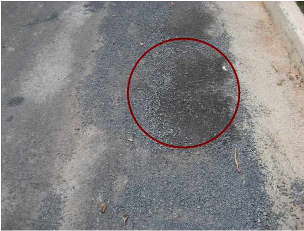
Foto 1: Camada asfáltica sem ligamento
