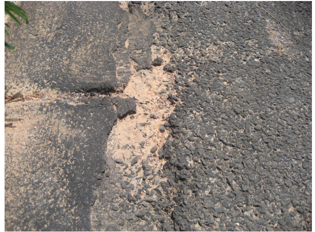
Foto 8: Defeito entre a sarjeta e a pista
