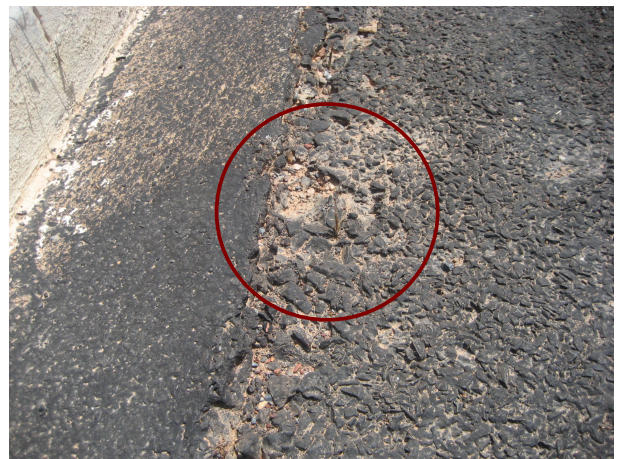
Foto 4: Defeito na camada asfáltica
