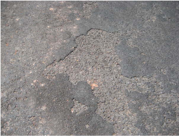
Foto 13: Pista com defeito
