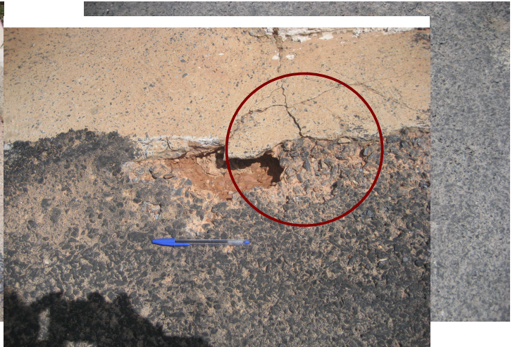
Foto 3: Buraco entre a sarjeta e a pista
