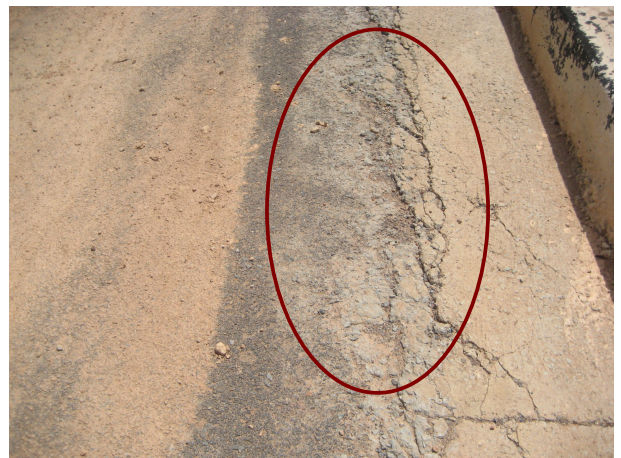
Foto 6: Camada asfáltica deteriorando
