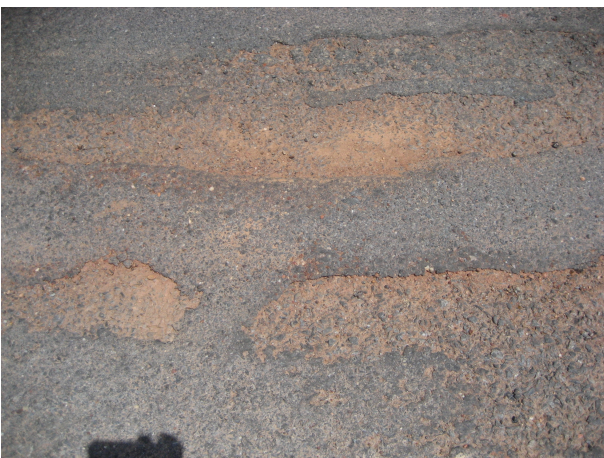
Foto 11: Defeito na pista
