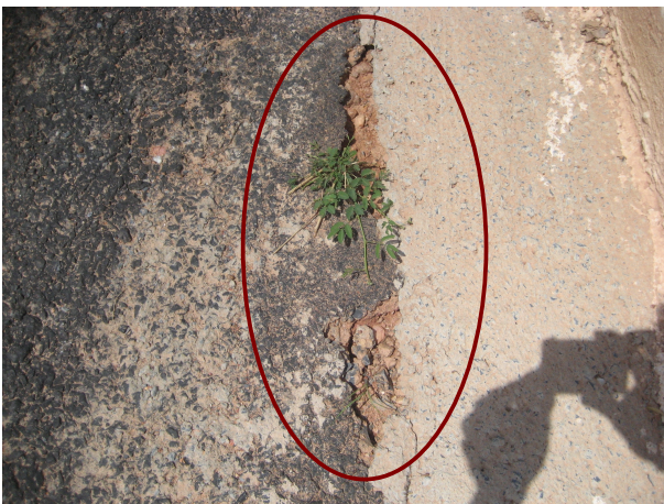
Foto 5: Buraco entre a sarjeta e a pista
