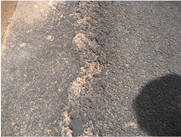
Foto 7: Defeito na pista
