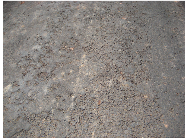
Foto 14: Pista com defeito
