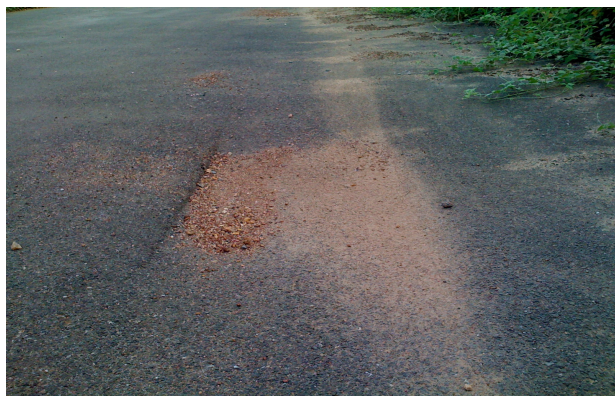
Foto 5: Pista co afundamento
