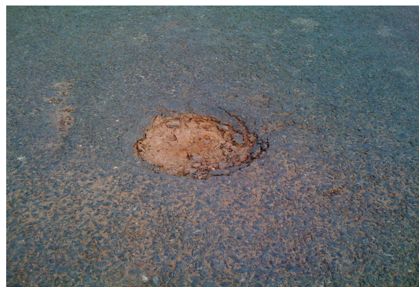
Foto 4: Buraco na Pista
