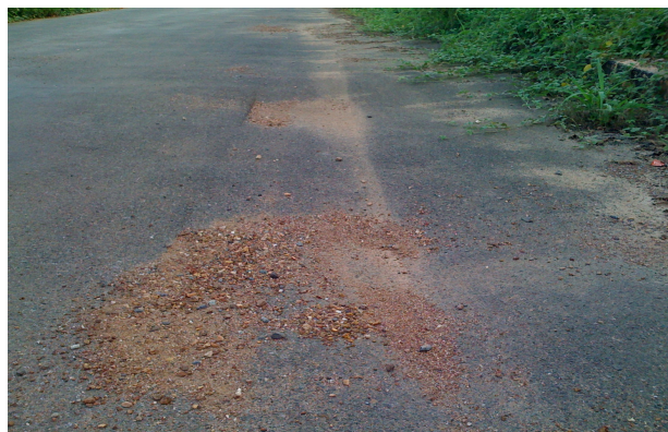
Foto 6: Pista com afundamento
