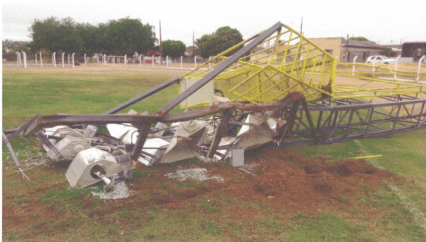
Figura 6: Conjunto de Refletores danificados.
