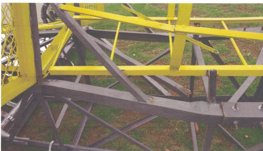
Figura 8: Estrutura da torre danificada.
