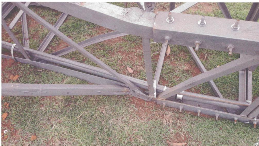
Figura 7: Estrutura da torre danificada.
