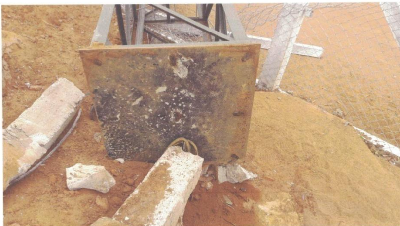
Figura 1: Base da Torre danificada.
