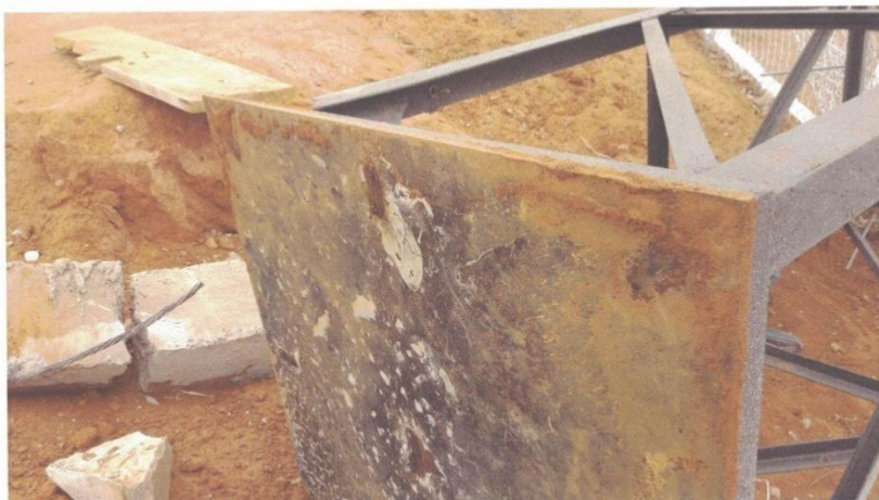
Figura 2: Base da torre danificada.
