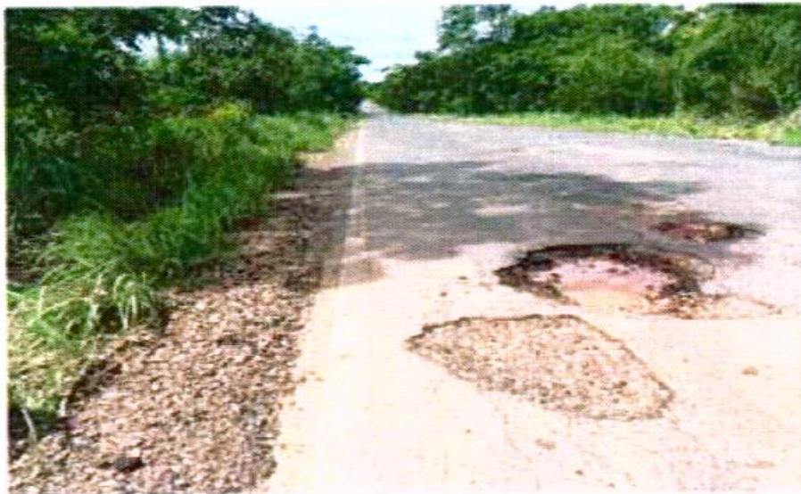
Estaca 326 - Painelas que requer remendo profundo e necessita de recomposição do acostamento
