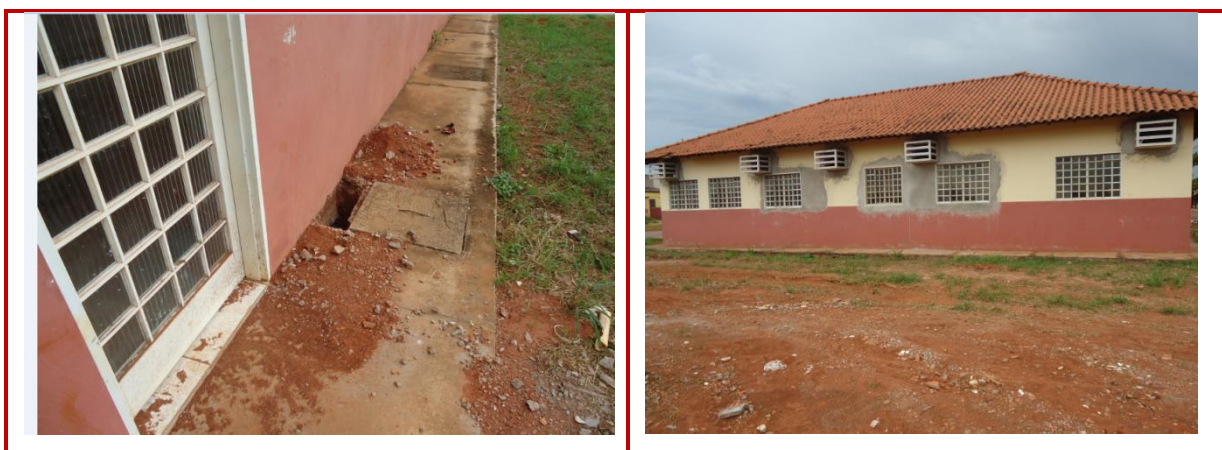
Situação de abandono da obra na creche
