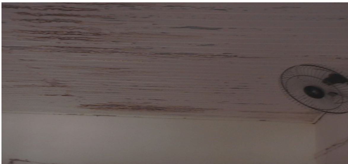
Foto – 005 – Teto Escola – todo danificado – podendo causar problema respiratório.
