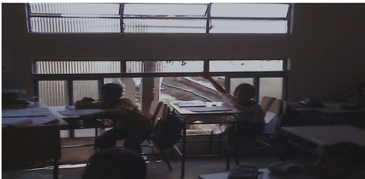
Sala de Aula – janela sem vidro
