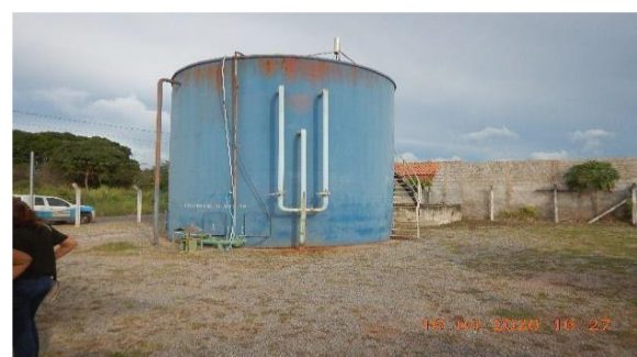
Figura 19 - Reator da ETE Aeroporto
