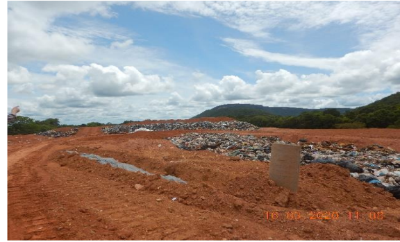
Figura 27 - Vista do dreno de gases e dreno de célula, para chorume. (Aterro Sanitário)
