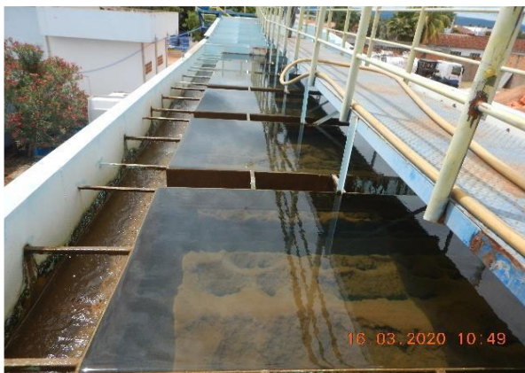
Figura 7 - Decantador da ETA metálica
