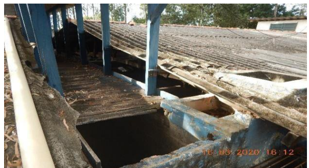
Figura 17 – Instalações precárias na ETE Cohab Nova
