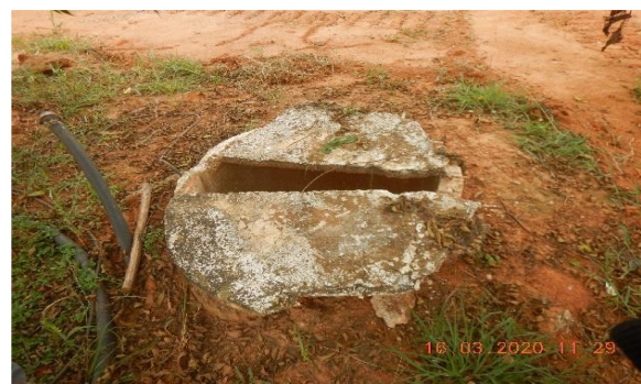
Figura 29 - Tanque de acumulação de chorume, oriundo do maciço do aterro
