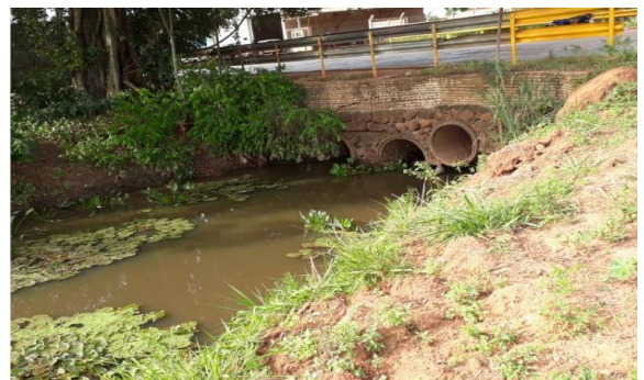
Figura 43 - Bueiro tubular com erosão inferior, no córrego Lavapés
