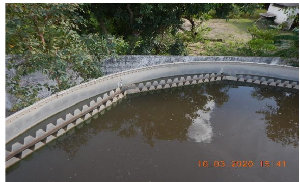
Figura 15 - Unidade de decantador (ETE Dom Máximo)
