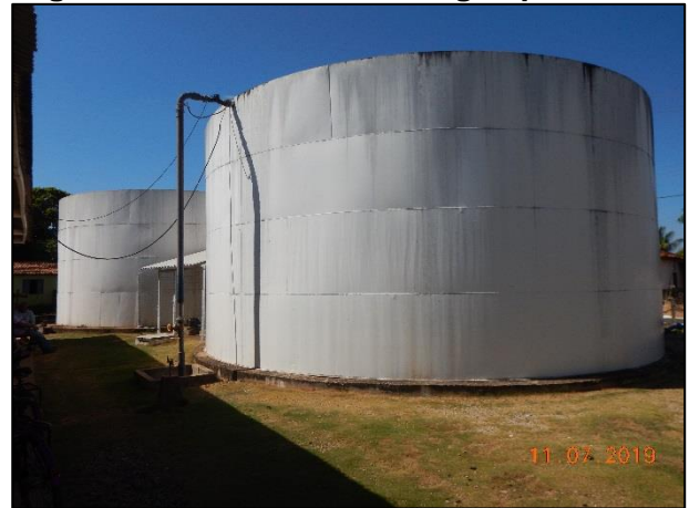
Figura 6 – Reservatório de água potável.
