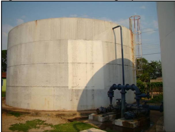
Figura 5 – Reservatório de água potável.
