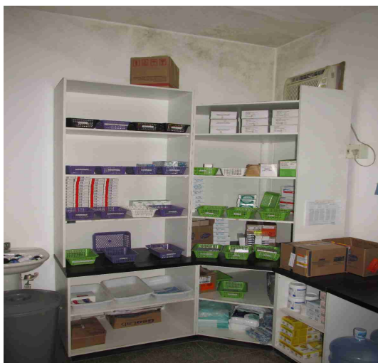
Foto 7 – Sala de medicamentos com infiltração.
