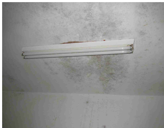
Foto 8 – Teto com infiltração.
