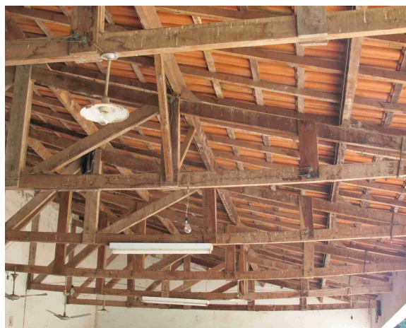
Foto 15 – Denúncia de risco de desabamento do teto. Escritório Regional de Saúde - Cáceres Fonte: Equipe de auditoria
