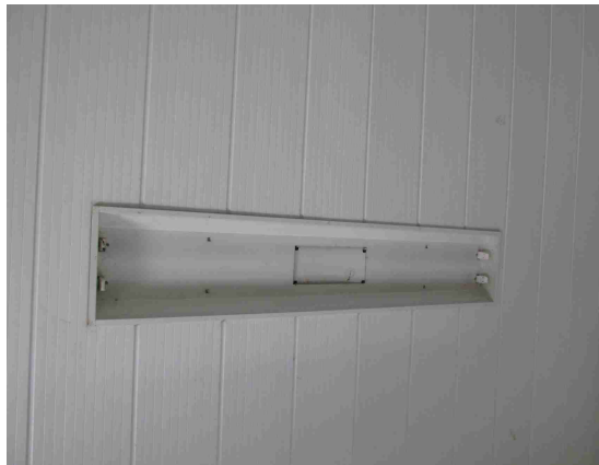
Foto 6 – Falta de lâmpadas.
