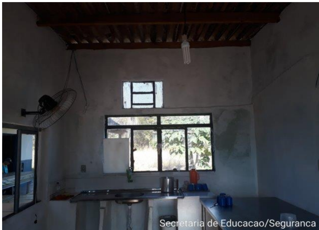
Ausência de forro
