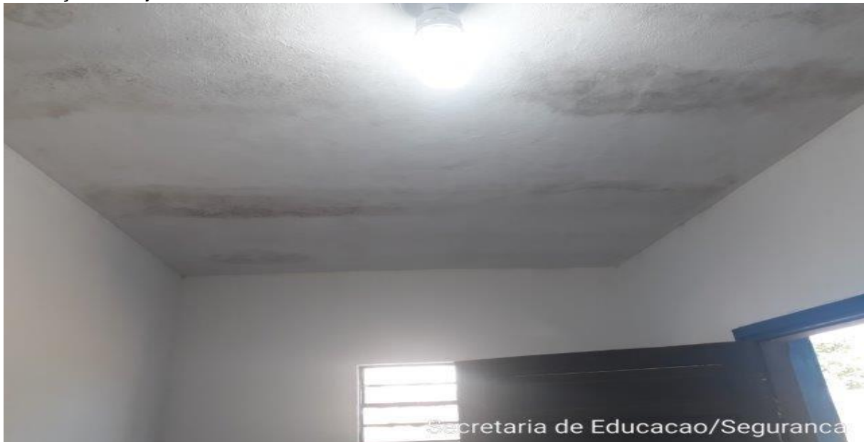
Infiltração na laje
