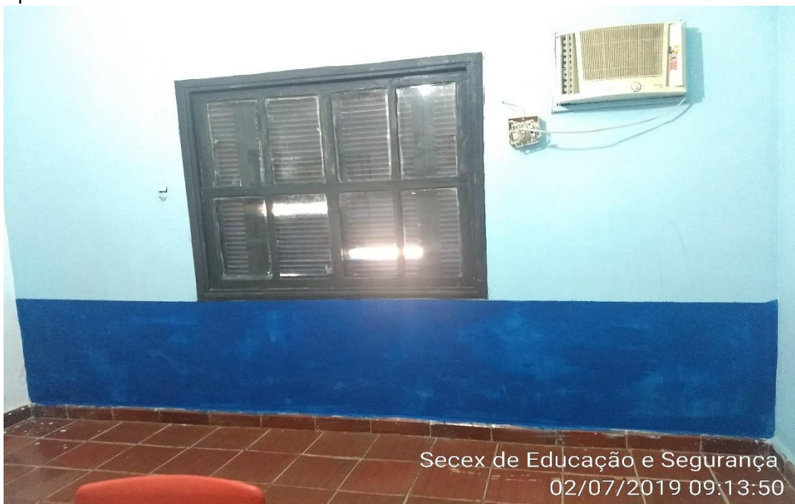
Aparelhos de ar condicionado
