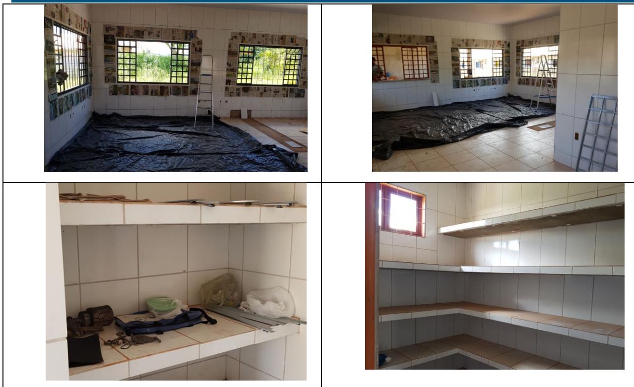
Figura 17 - Execução de banheiros, os quais já estão em uso e da cozinha na Escola Municipal de Educação Básica Gracildes de Melo Dantas.
