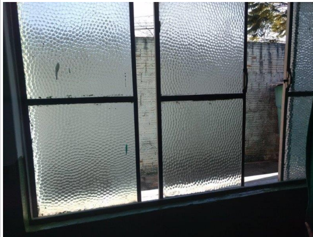
Foto: janela danificada – corre em toda extensão – 4º ano B
