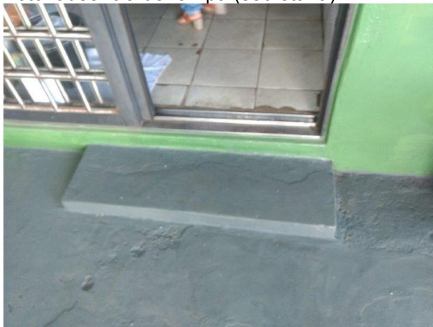
Foto: ausência de rampa (secretaria)
