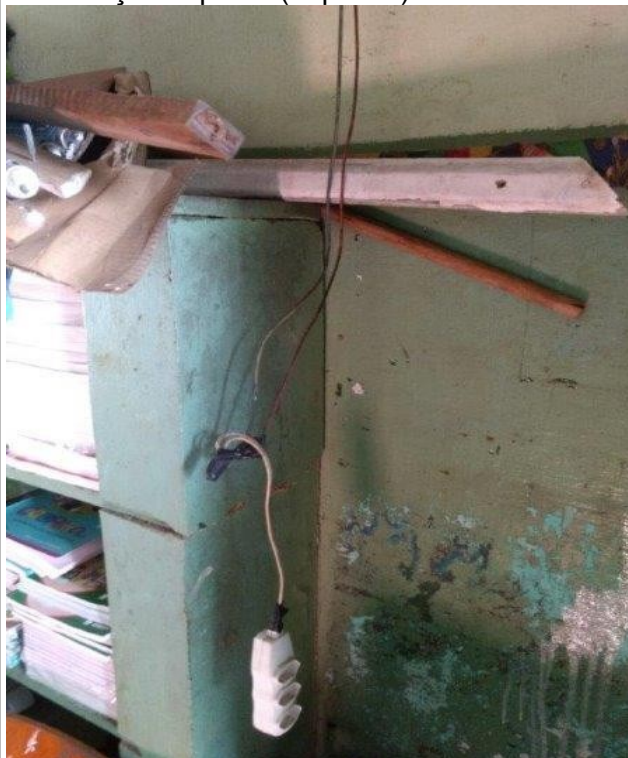
Foto: fiação exposta (depósito)
