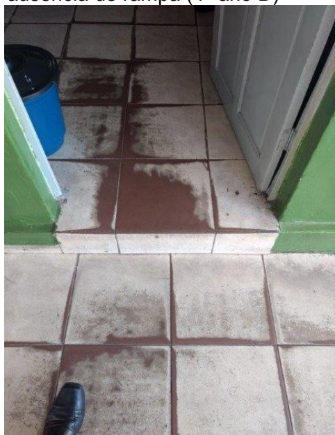
Foto: ausência de rampa (4º ano D)
