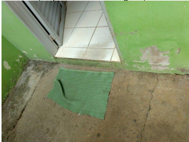
Foto: falta de rampa de acesso ao sanitário feminino (no prédio anexo - alugado)
