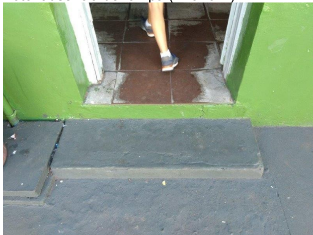
Foto: ausência de rampa (2° ano D)
