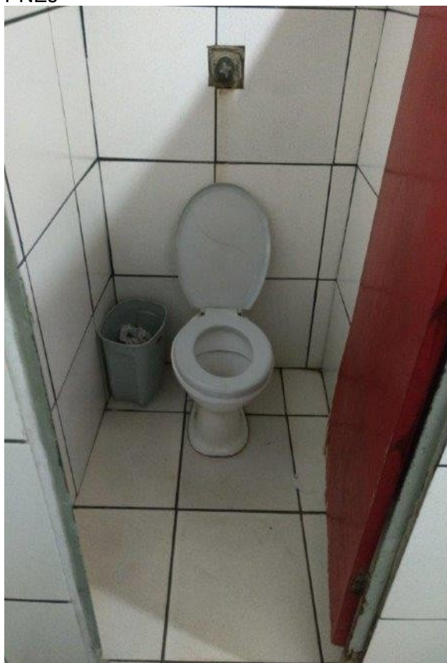
Foto: sanitário feminino – não adaptado para PNEs
