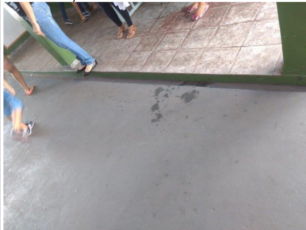
Foto: ausência de rampa (para chegar ao bebedouro)
