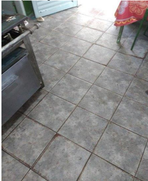
Foto: piso desgastado – cozinha
