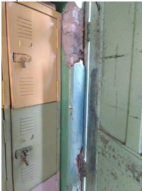
Foto: queda de reboco
