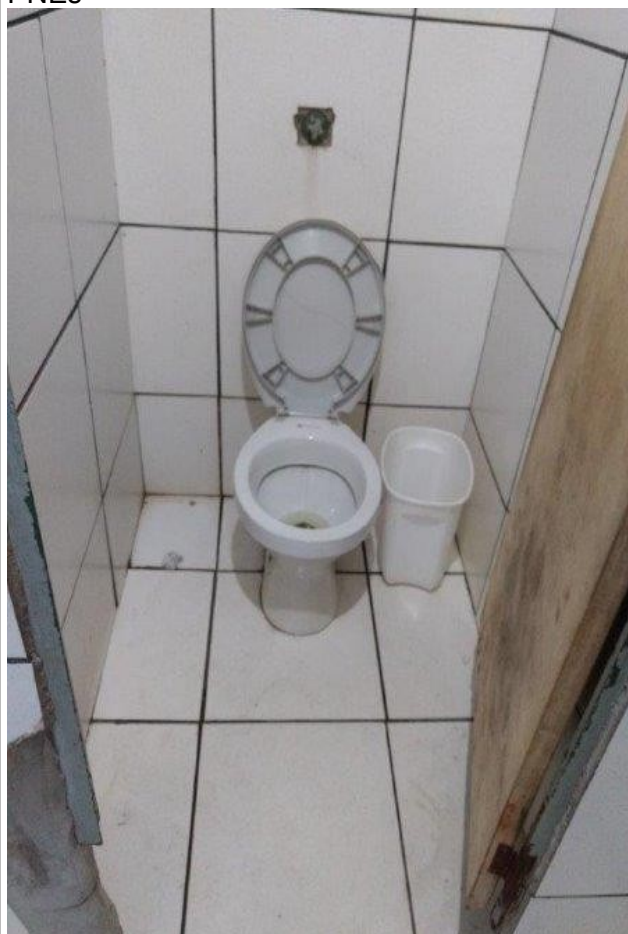
Foto: sanitário masculino – não adaptado para PNEs
