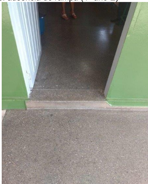
Foto: ausência de rampa (4º ano E)
