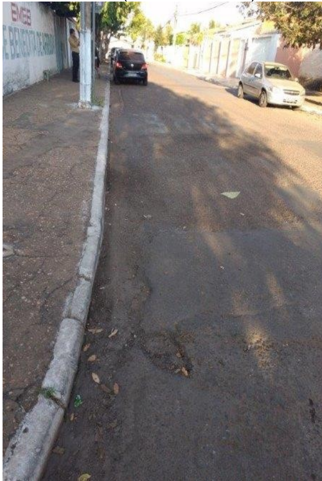
Foto: ausência de faixa de pedestre e o meio fio não foi rebaixado (em frente à escola)
