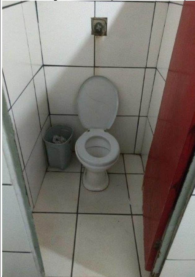
Foto: descarga danificada (sanitário feminino)
