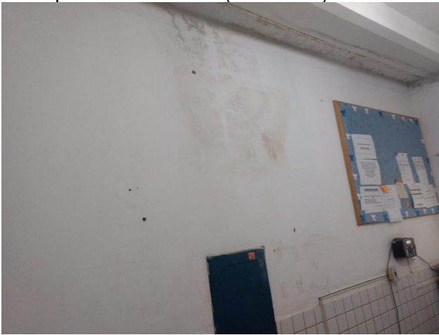
Foto: pintura danificada (secretaria)
