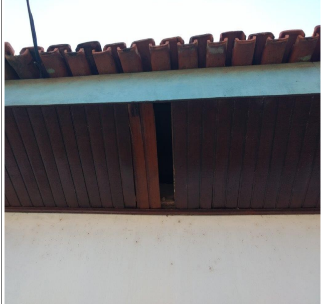
Foto: forro danificado (beiral da escola)
