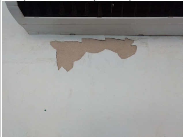
Foto: pintura danificada (2° ano C)
