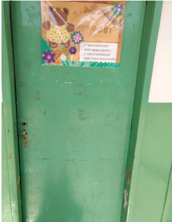
Foto: pintura danificada (externa às salas de aula)
