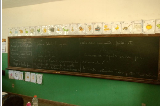
Foto: quadro desgastado (3º ano B)
