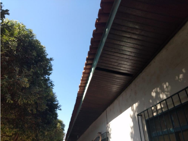
Foto: forro danificado (beiral da escola)
