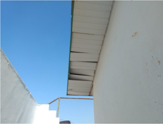
Foto: forro danificado (beiral da escola)
