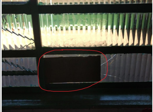
Foto: vidraça quebrada (sala multifuncional)
