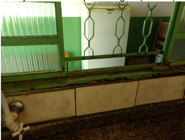
Foto: janela corroída pela ferrugem (cozinha)
