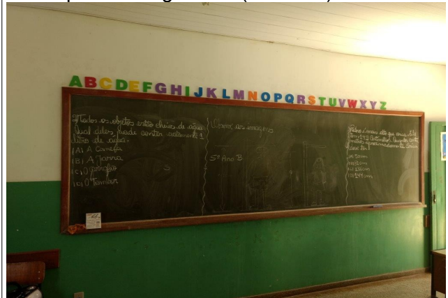
Foto: quadro desgastado (5º ano B)
