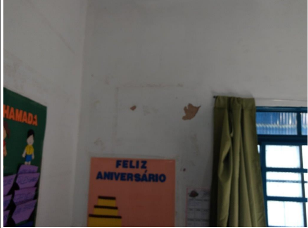
Foto: pintura danificada (educação infantil C)
