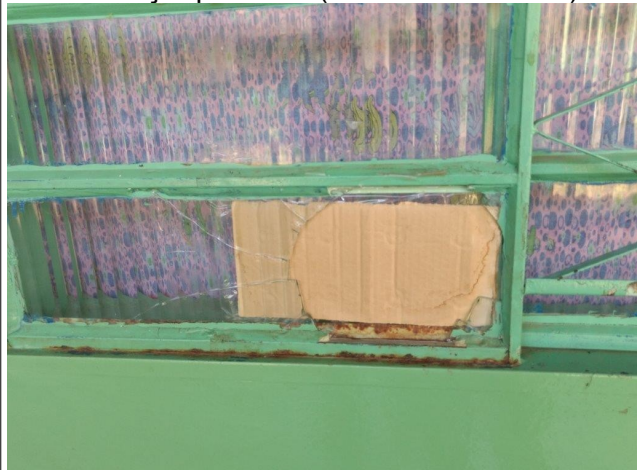
Foto: vidraça quebrada (sala multifuncional)
