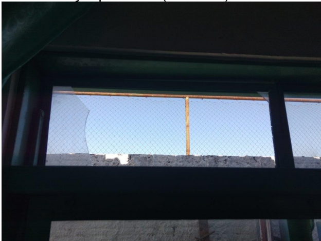
Foto: vidraça quebrada (5° ano B)
