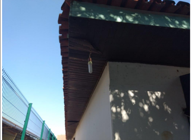
Foto: telhas e forro danificados (beiral da escola)
