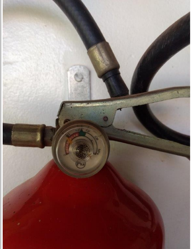
Foto: extintor 2 – vencido e despressurizado
