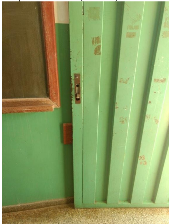
Foto: porta danificada (4° ano B)
