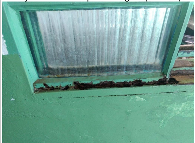
Foto: janela corroída pela ferrugem (cozinha)
