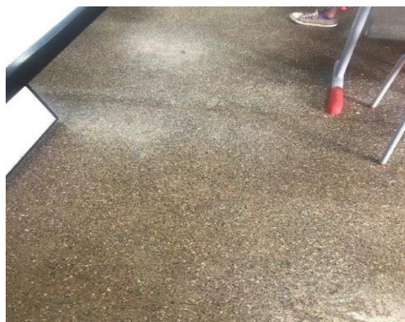
PISO DESGASTADO (LAB. INFOR ATUAL SALA 01)
