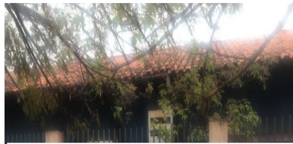
TELHADO COM PROBLEMAS DE GOTEIRAS
