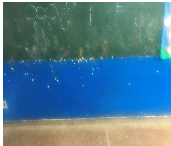
PAREDES COM PINTURA DESGASTADA
