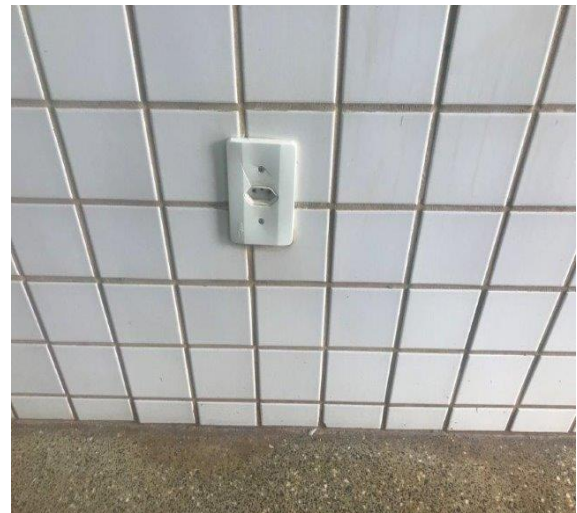
TOMADA FUNCIONA SALA 01 ( ATUAL SALA 02)
