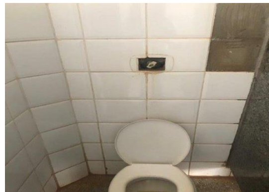
ACIONADOR DE DESCARGA DANIFICADO (SANITÁRIO MASCULINO)
