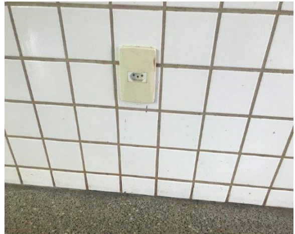
TOMADA DA SALA 10 FUNCIONANDO
