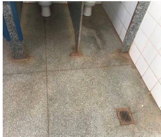
ACÚMULO DA ÁGUA NO PISO DEVIDO A VAZAMENTOS
