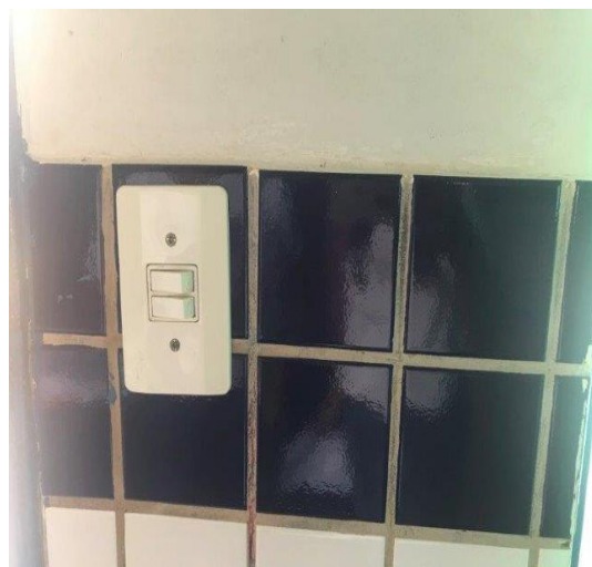
INTERRUPTOR FUNCIONANDO SALA 2º C
