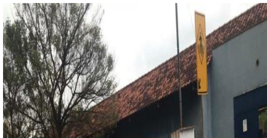
TELHADO NÃO FOI REFORMADO
