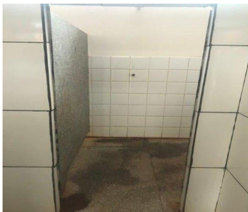
FALTA DE TORNEIRA NO CHUVEIRO (SANITÁRIO MASCULINO)
