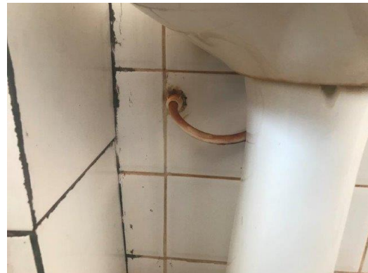
ENCANAMENTO COM VAZAMENTO (SANITÁRIO FEMININO)
