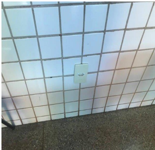
TOMADA ENCAPADA NA SALA DE AULA 08
