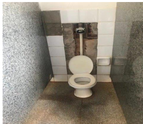
ENCANAMENTO EXPOSTO EM VASO (SANITÁRIO MASCULINO)
