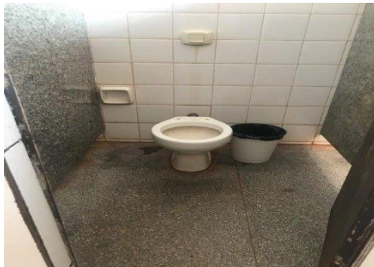
VASO SEM ASSENTO E SEM TAMPA (SANITÁRIO FEMININO)
