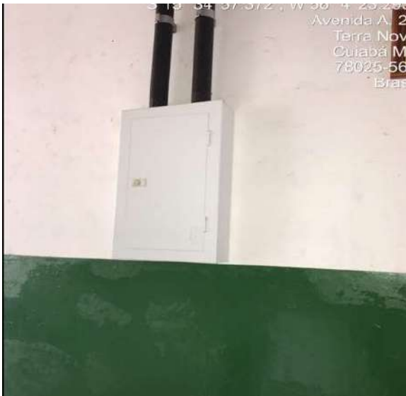
Quadro de distribuição de energia
