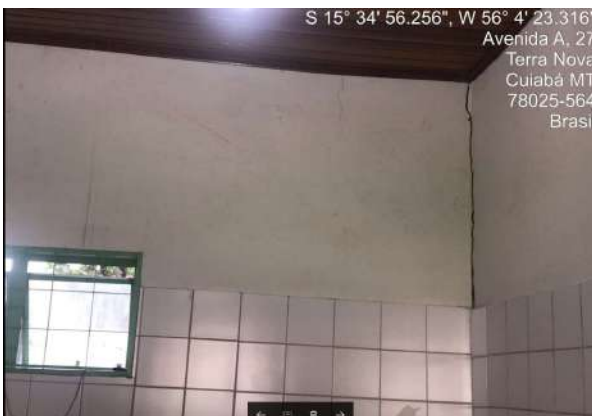
Rachaduras nas paredes do banheiro
