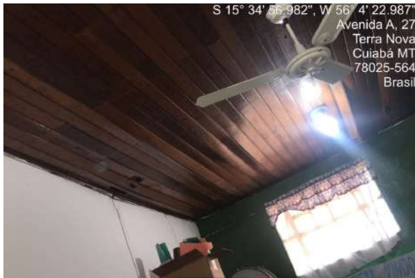
Alguns ventiladores em bom estado
