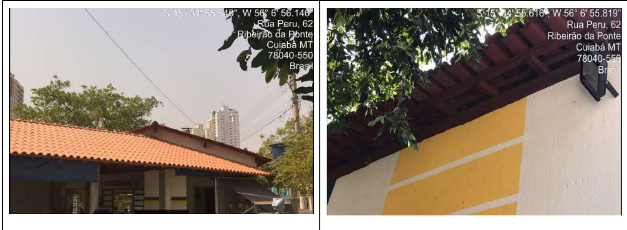
Relatório fotográfico – parte do telhado e madeiramento da cobertura –Creche Macaria Militona.
