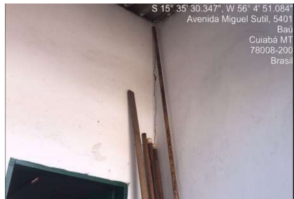
Rachaduras na alvenaria
