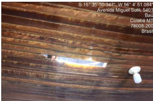
Risco de desabamento do telhado da biblioteca
