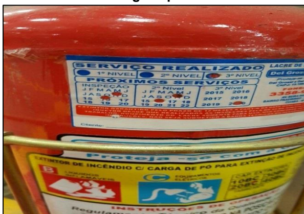
Foto 16 – Extintor de incêndio com data de validade da carga expirada no CDMIC
