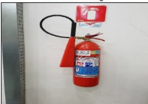
Foto 15 – Extintor de incêndio dentro da data de validade da carga
