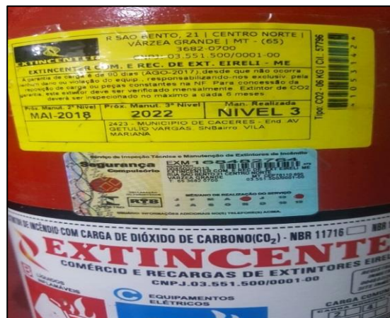
Foto 13 – Extintor de incêndio na Farmácia Básica Central
