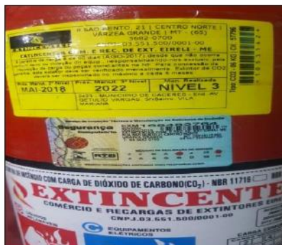
Foto 13 – Extintor de incêndio na Farmácia Básica Central
