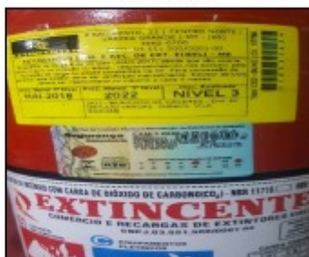
Foto 15 - Extintor de incêndio na Farmácia Básico Central
