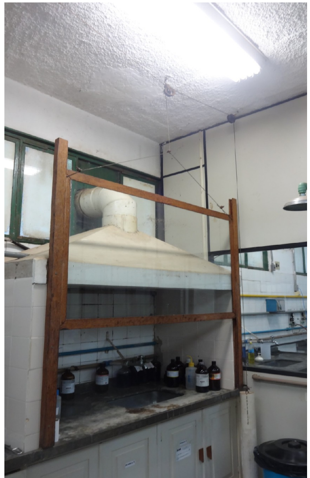
Capela desatualizada, com corrosão da pedra interna
