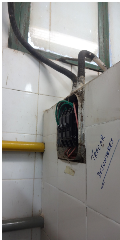
Instalação Elétrica precária
