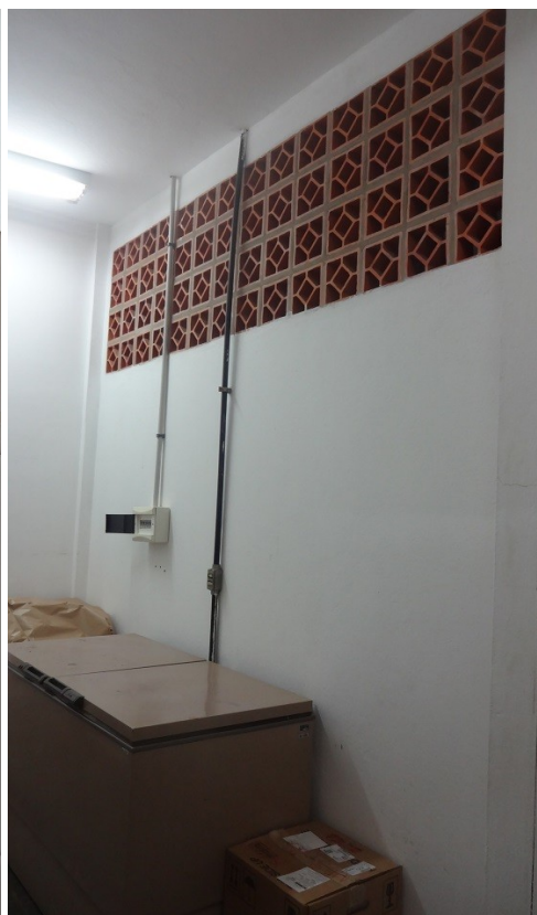
Sala de Reagentes: parede com tijolos vazados da sala de reagentes com o corredor principal, que exala vapores de reagentes tóxicos, sendo prejudicial para as pessoas que trabalham neste ambiente.
