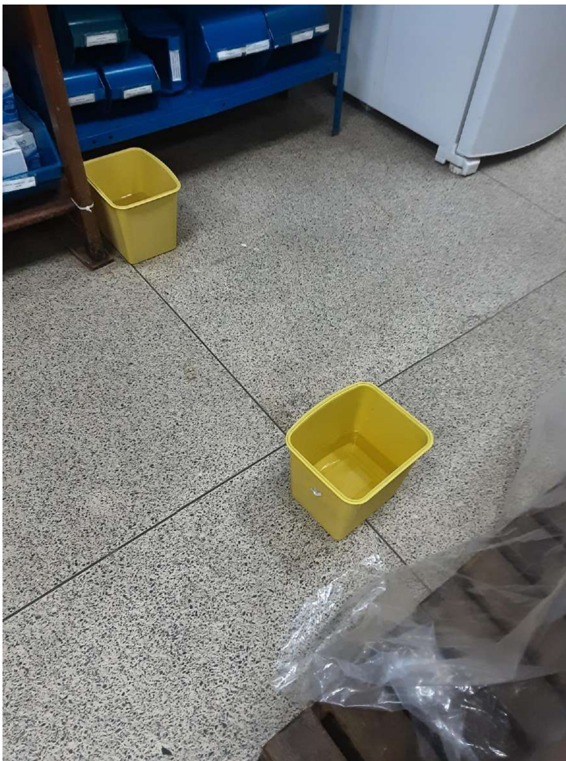
FOTO 14 – BALDES NO CHÃO PARA APARAR GOTEIRAS.
