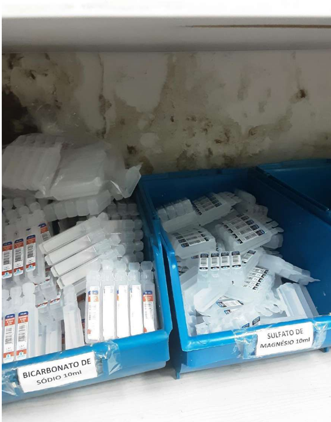
FOTO 12 – PAREDE COM INFILTRAÇÃO E MOFO
