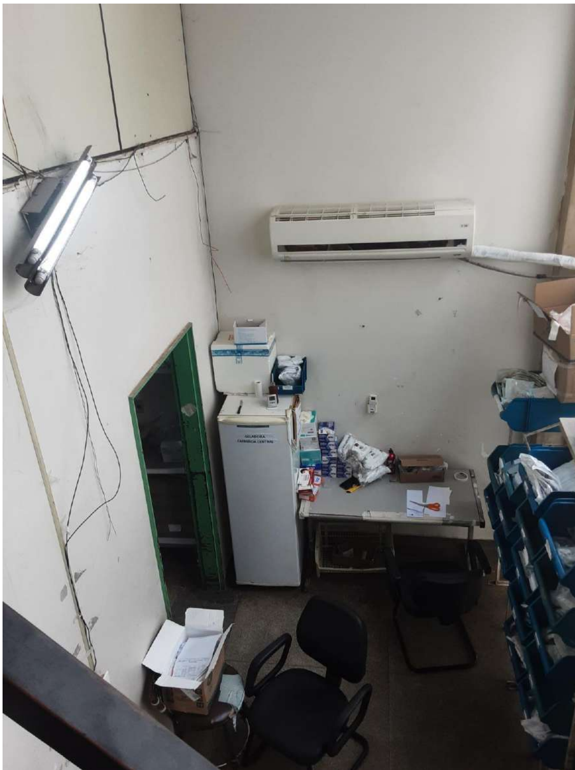
FOTO 11 - AMBIENTE DESORGANIZADO E FIAÇÕES EXPOSTAS
