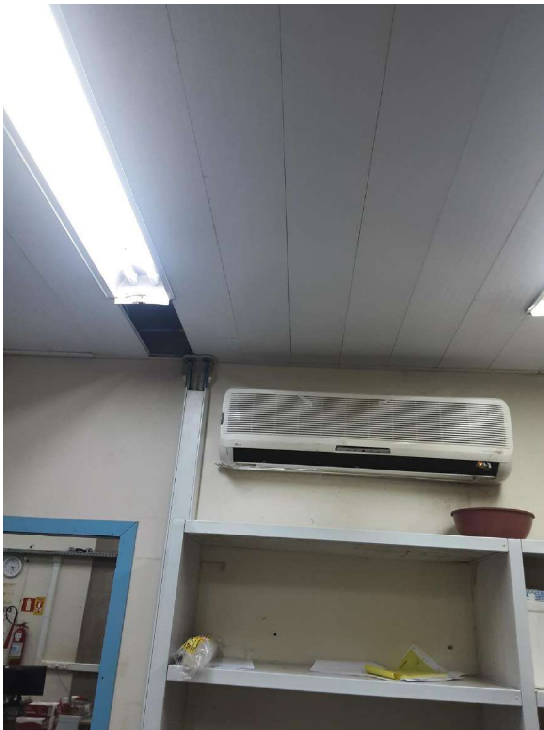
FOTO 8 – MAL FUNCIONAMENTO DO AR CONDICIONADO APRESENTANDO VAZAMENTOS
