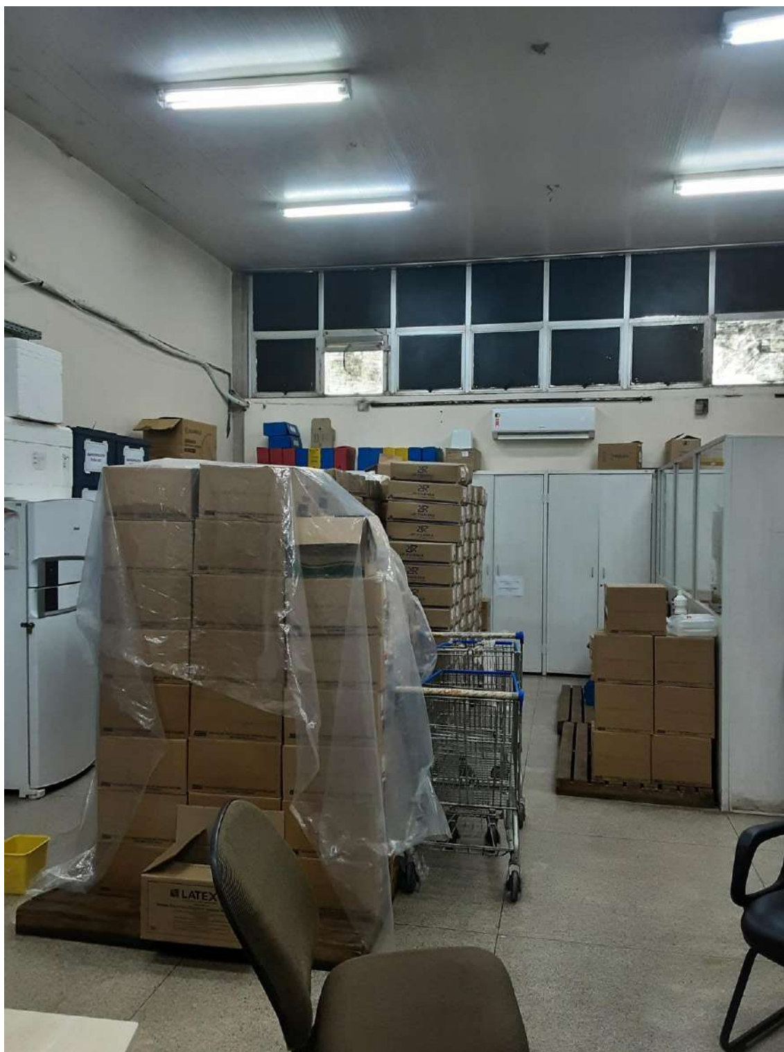
FOTO 13 – SINAIS DE GOTEIRAS. LONA PLÁSTICA COBRINDO AS CAIXAS.
