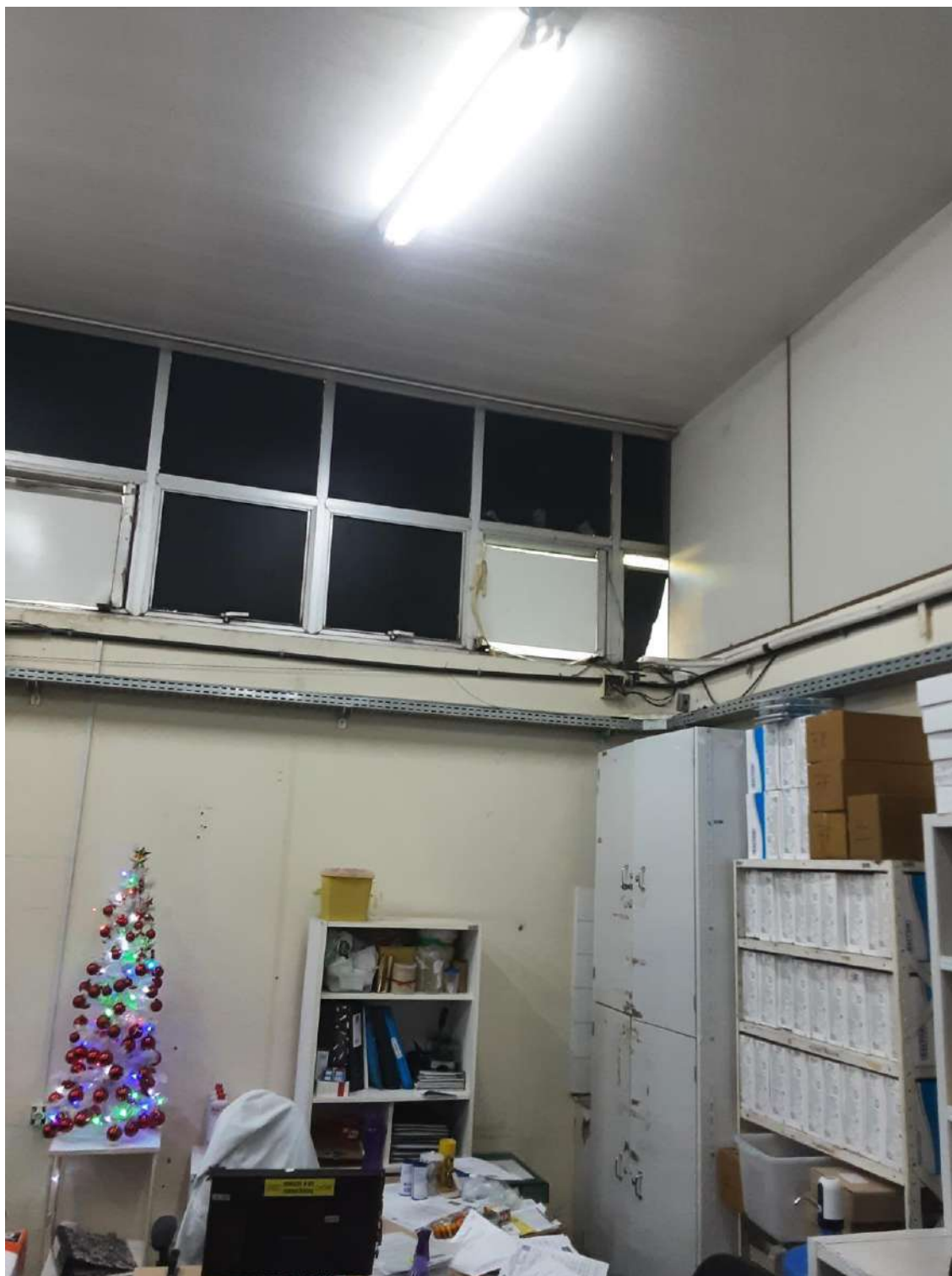
FOTO 10 – AMBIENTE DESORGANIZADO E FIAÇÕES EXPOSTAS
