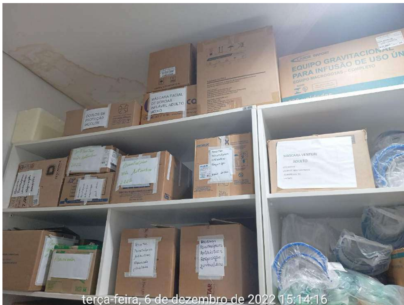
Imagem 51: Infiltração no teto da área de armazenamento da farmácia
