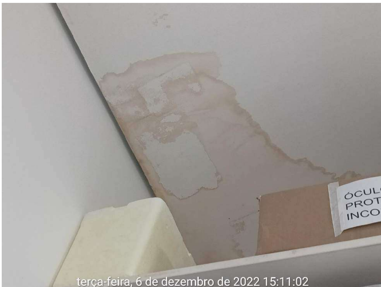
Imagem 50: Infiltração no teto da área de armazenamento da farmácia
