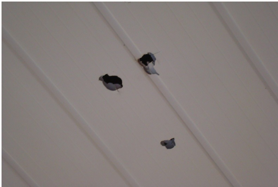
Utilização de material danificado na execução do forro
