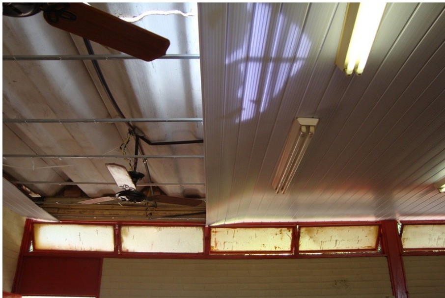
✓ Deslocamento forro PVC
