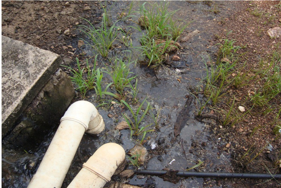
Deficiência na destinação final dos efluentes.
