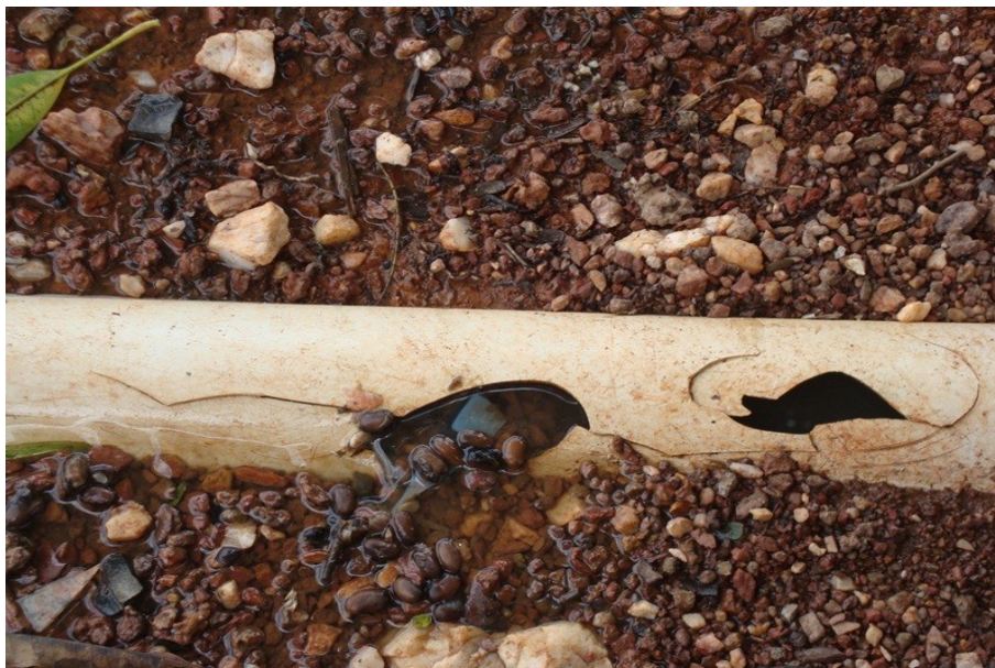
Tubulação de esgoto exposta as ações das intempéries e a atos de vandalismo
