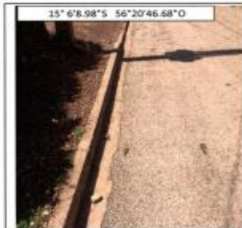
Foto 3 - Rua Lourenço C. Teixeira [Sarjeta executada à menor] / Canta Galo.
