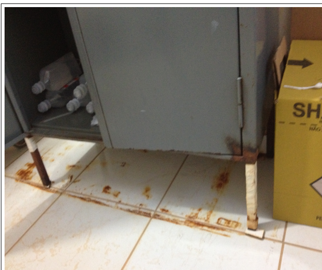
Sala de Procedimento - Armário em péssima condição
