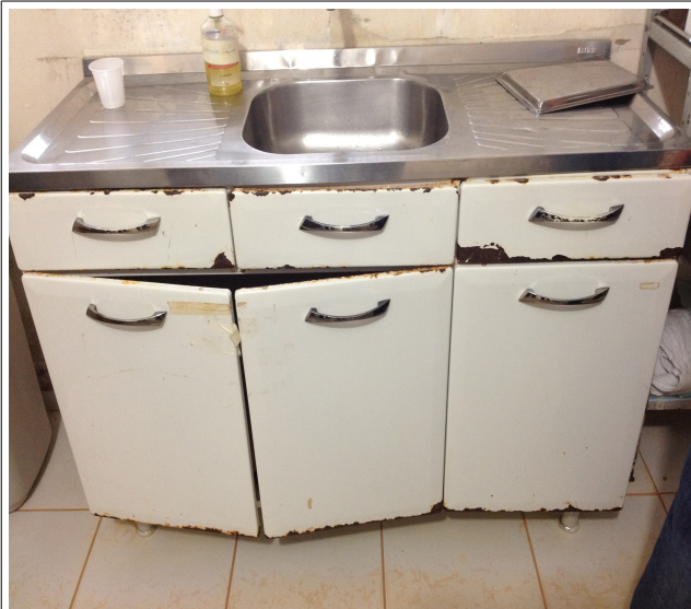
Sala de Procedimento - Armário em péssima condição
