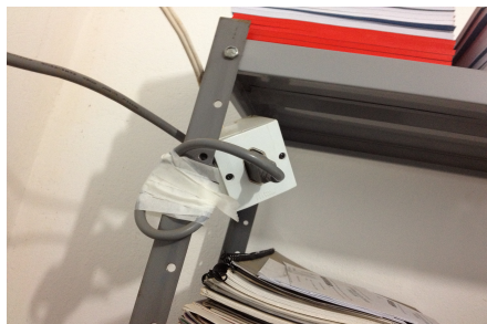
Fiação elétrica exposta colocando a unidade em risco de incêndio
