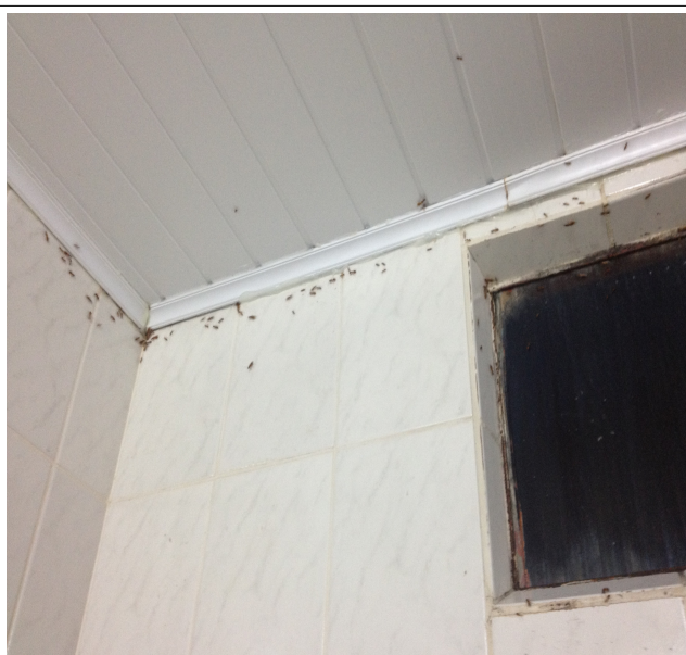
Centro Cirúrgico - Grande quantidade de insetos dentro do centro cirúrgico
