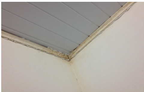
Infiltração e mofo nas paredes
