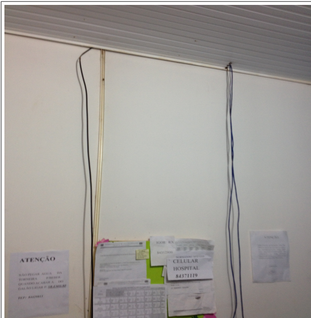
Recepção - Fiação elétrica exposta colocando o hospital em risco de incêndio
