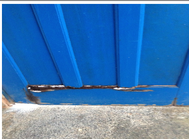
Porta em mau estado
