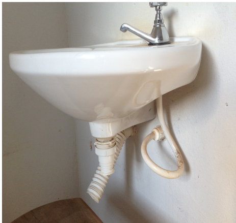
Encanamento quebrado da pia
