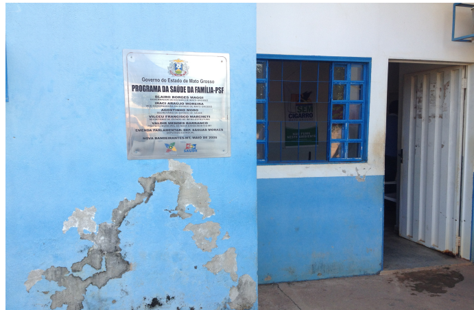
Fachada com infiltração e pintura desgastada
