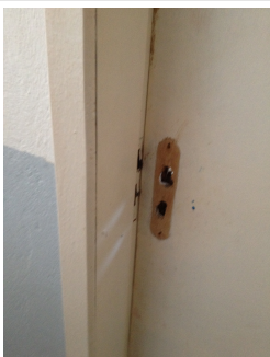
Ausência de fechadura
