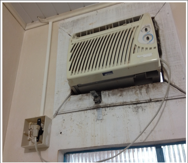
Consultório Médico – Fiação exposta e mofo
