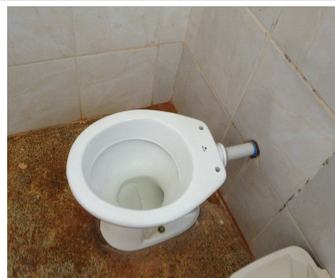
Ausência de tampa da privada
