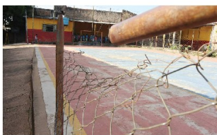
Nem salas de aula nem quadras de esportes em condições dignas de uso
