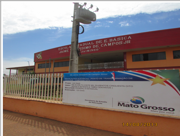
Rede Elétrica instalada.
