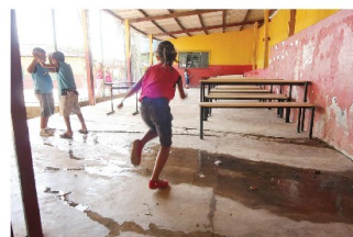
Crianças brincam nos corredores tomados pela água suja dos esgotos
