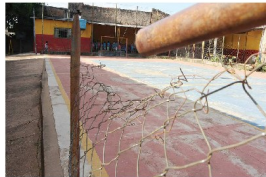
Nem salas de aula nem quadras de esportes em condições dignas de uso
