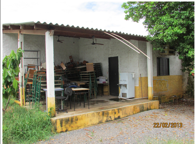
Local que deveria ser a cantina. Atualmente depósito de móveis estragados.
