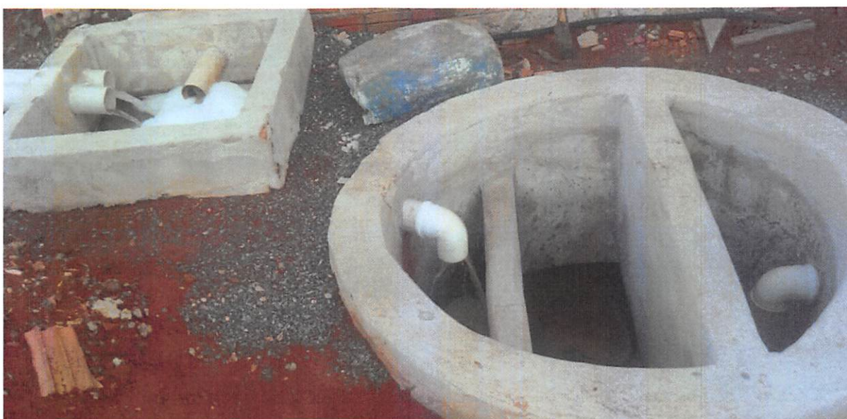
Caixas separadoras - lavagem de peças e oficina
