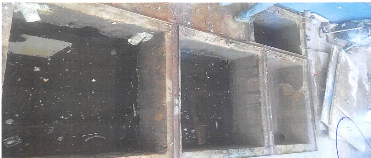
Caixas separadoras - troca de óleo e lavagem de veículos
