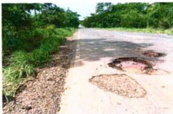
Estaca 326 - Painéis que requer remendo profundo e necessita de recomposição do acostamento
