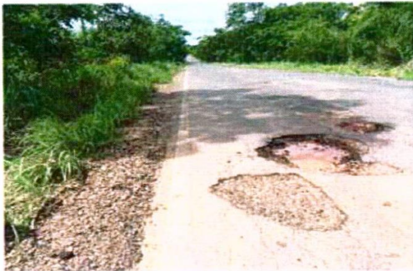
Estaca 326 - Painelas que requer remendo profundo e necessita de recomposição do acostamento
